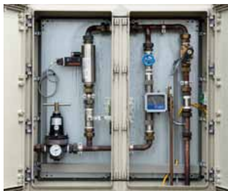
Integrované potrubí měřící průtok v zařízení SOLVOX
